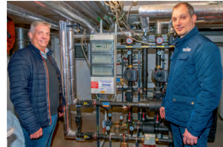
Geschäftskunde Mathias Wölk und Stadtwerke-Mitarbeiter Stephan Riediger bei der Besichtigung der neuen Kundenanlage
