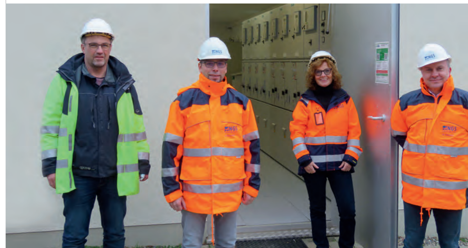
Das Team der Netzgesellschaft Schwerin mbH (NGS) bei der Inbetriebnahme der neuen Mittelspannungsschaltanlage
